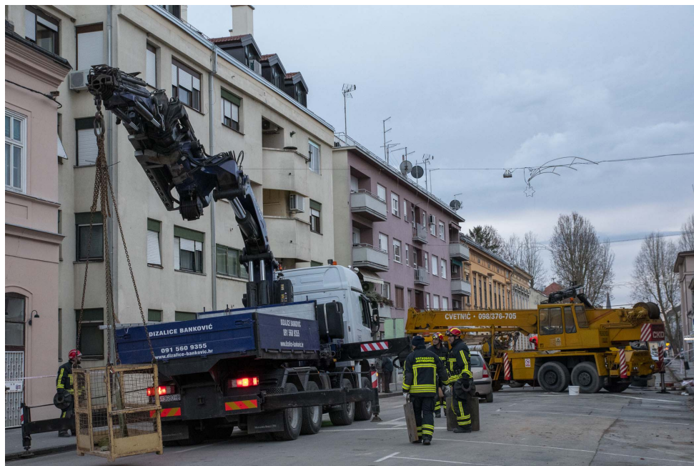
Slika 8. Čišćenje Grada nakon potresa
