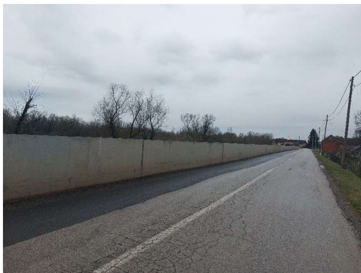
Slika 45. Izvođenje zahvata na obrani od poplave u Uštici, Tancu, Košutarici, Mlaci i Višnjici- betonski nasip u naselju Tanac
